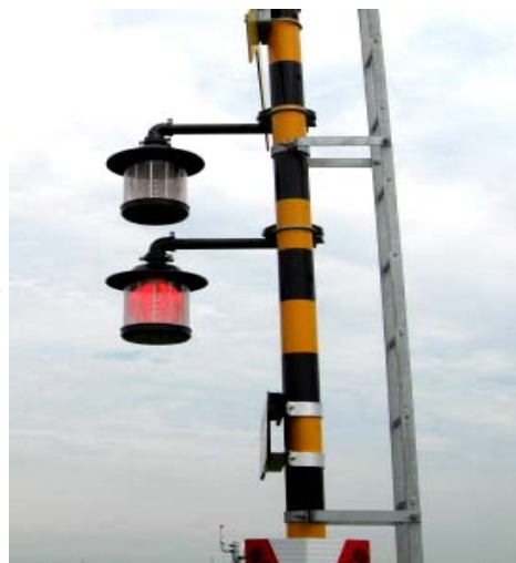
全方向踏切警報灯
