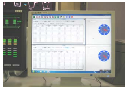
監視モニター
