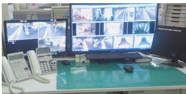
監視モニター
