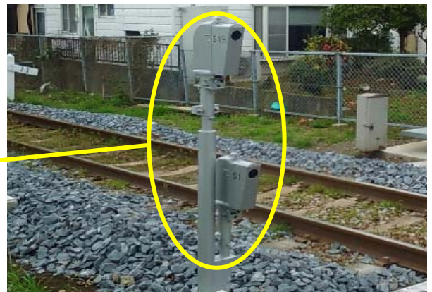
踏切障害物検知装置
