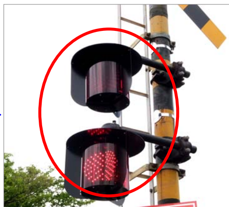
全方向踏切警報灯
