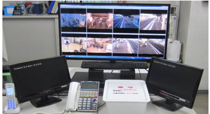
【監視モニター】
