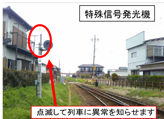
点滅して列車に異常を知らせます 三妻踏切道
