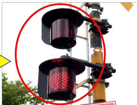
全方向踏切警報灯
