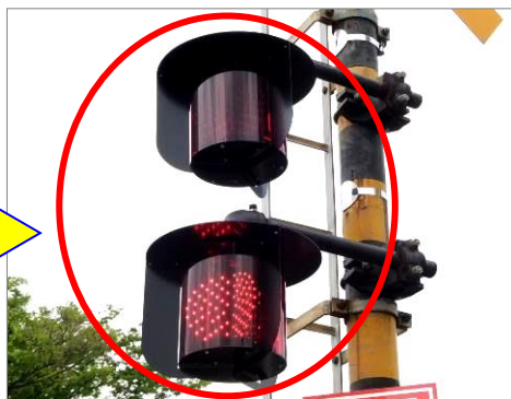
全方向踏切警報灯
