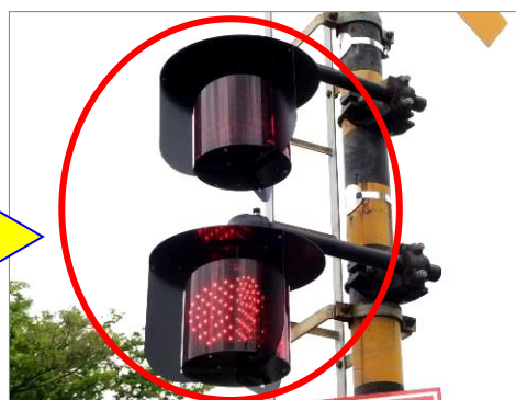
全方向踏切警報灯
