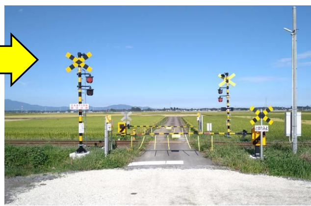
【格上げ後】第1種踏切道
