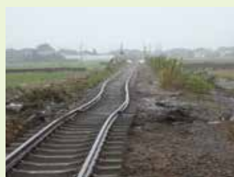
曲損した線路
